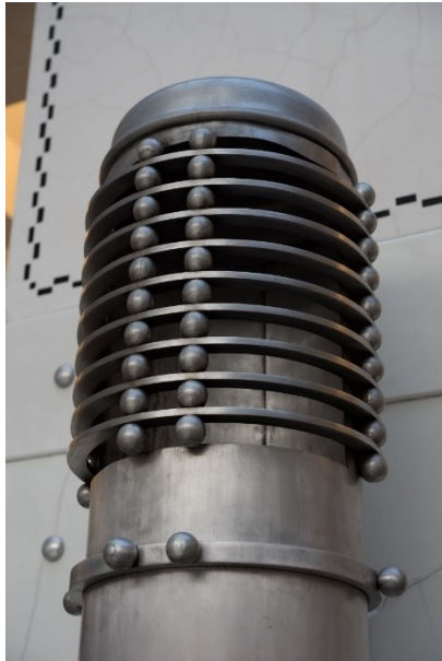
Abbildung 23: Detailansicht eines Lüftungssystems an der Fassade der Postsparkasse, Quelle: viennaslide / picturedesk.com
